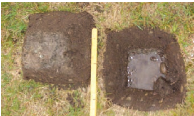
Figur 2. Stående vann i 15 cm tykt lag av anleggsjord over komprimert lag av leire og sprengstein. Foto: Tore E. Sveistrup
