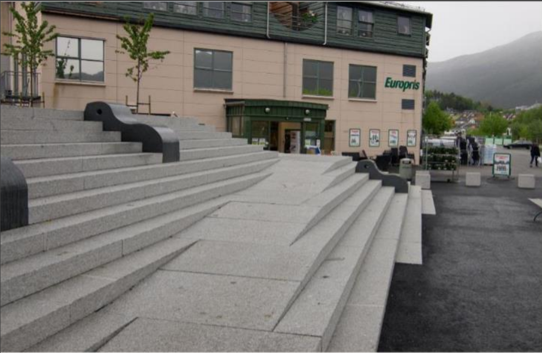
Farlig løsning med rampe i trapp
