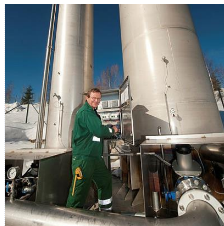
Fjernvarmeanlegg til Knive boligfelt
