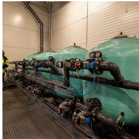
Oljebehandlingsanlegg (OBA) for avansert rensing av oljeforurensede masser.
